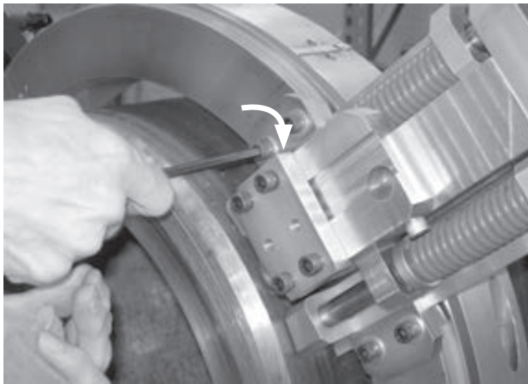
Figura 3-12. Una vez que las posiciones estén ajustadas, apriete firmemente los tornillos de las abrazaderas de montaje.
