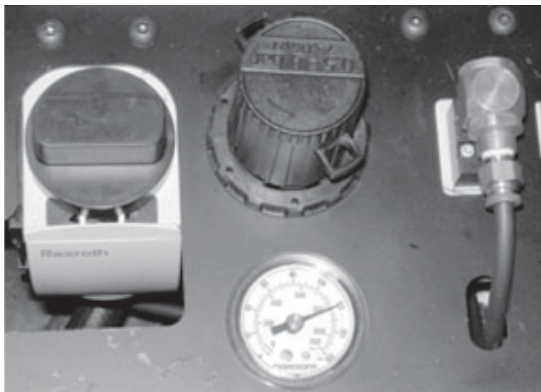
Рис. 5-85. Поворачивание рукоятки регулирования давления без вытягивания вверх открывает стопорные выступы. Вденьте замок сквозь выступы для предотвращения изменения уставки давления.
